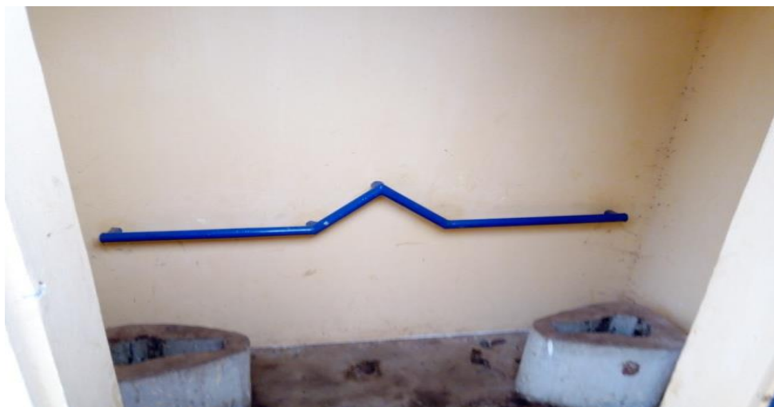
Construction de toilettes adaptées pour les enfants handicapés suite à l'engagement pris par les autorités communales au raffut
