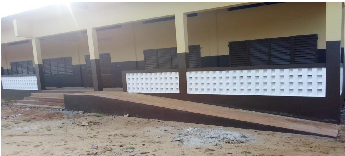
Réaménagement des modules de classe suite au raffut pour l'accessibilité physique des enfants handicapés
